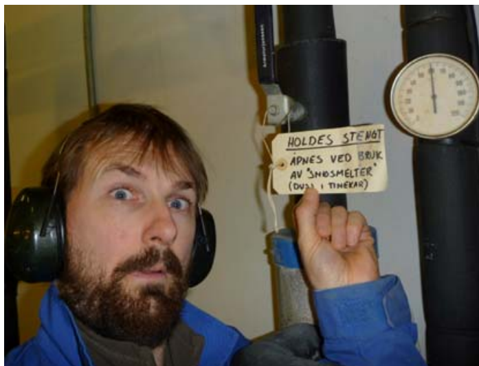
En noe oppskjært stasjonssjef holder opp lappen som ledet fram til motorhavariet. Lappen er nå flyttet til riktig ventil.
